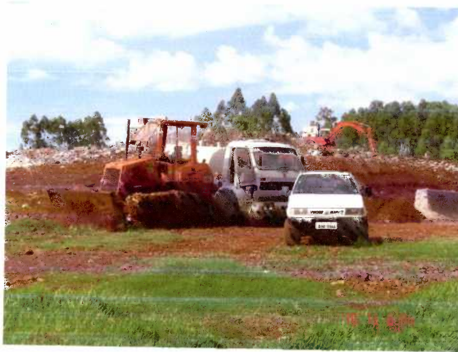
Figura 123 – Equipamentos de apoio no aterro sanitário municipal de Toledo-PR.
