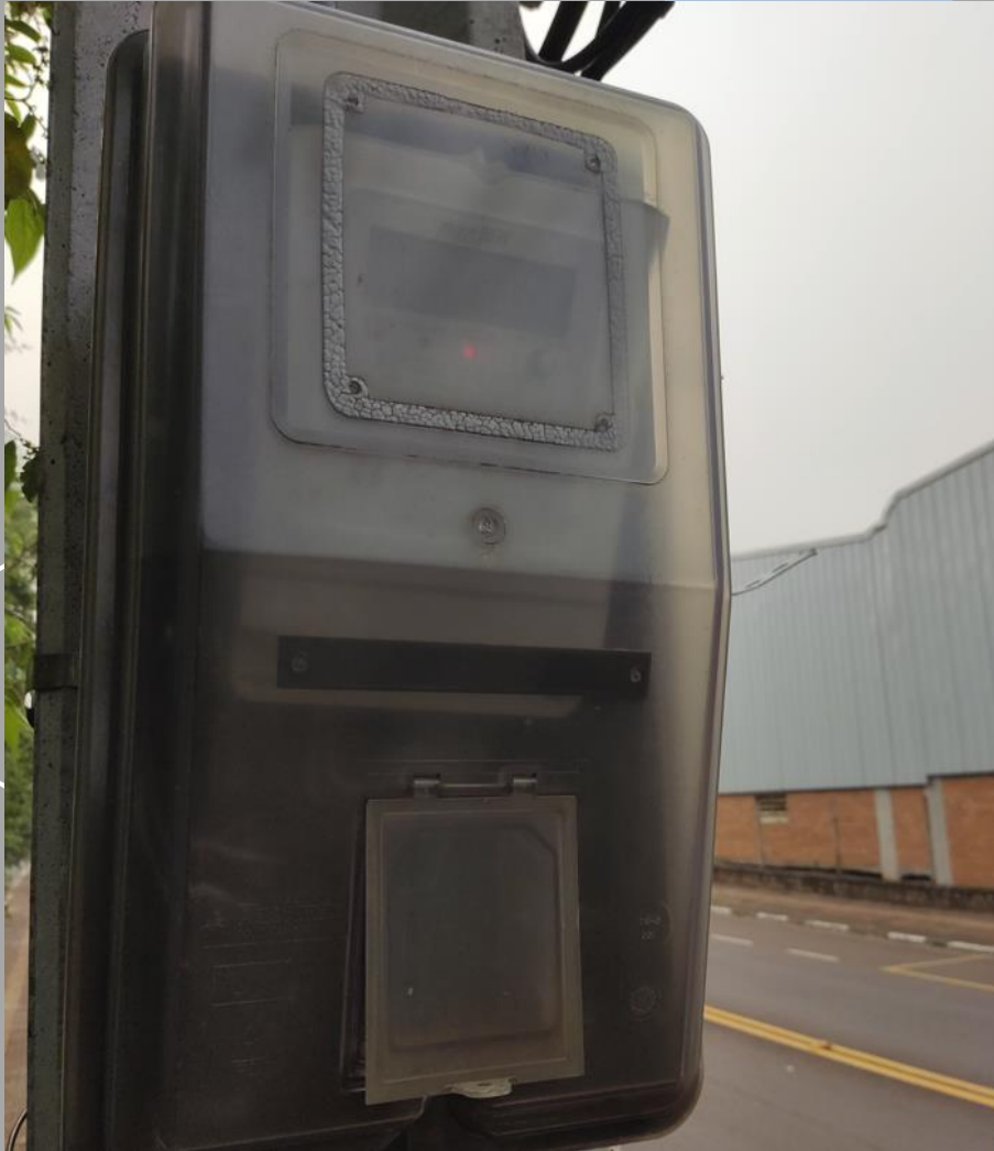
Figura: Caixa de medição com tampa de acrílico ofuscada
