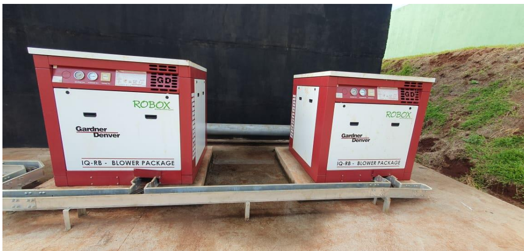
Figura: Disposição dos Sopradores I e II
