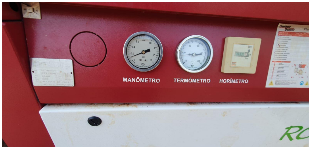
Figura: Soprador I
