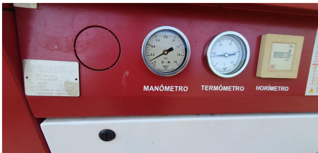
Figura: Soprador II
