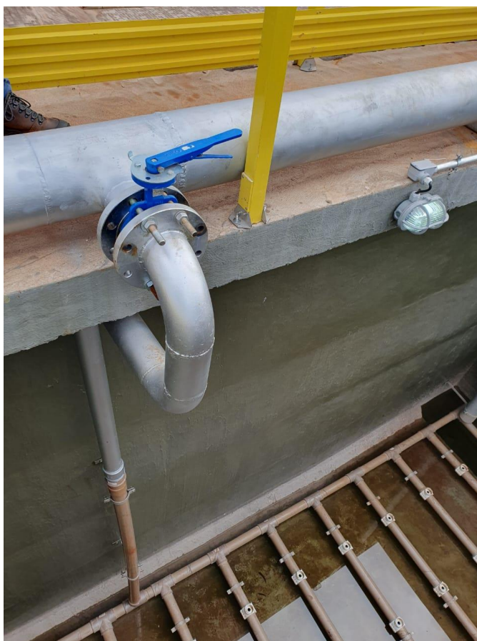
Figura: Tubulação soprador
